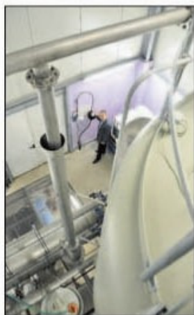
Blick in die Trinkwasser-Aufbereitungsanlage der Stadtwerke an der Fürwigge.
